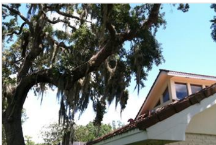
Ramas colgando sobre el techo
