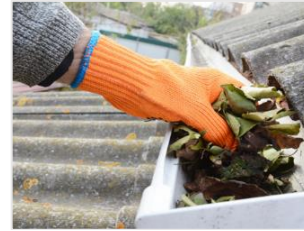
Residuos en una canaleta
