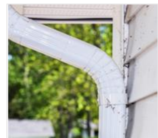
Unión de una canaleta
